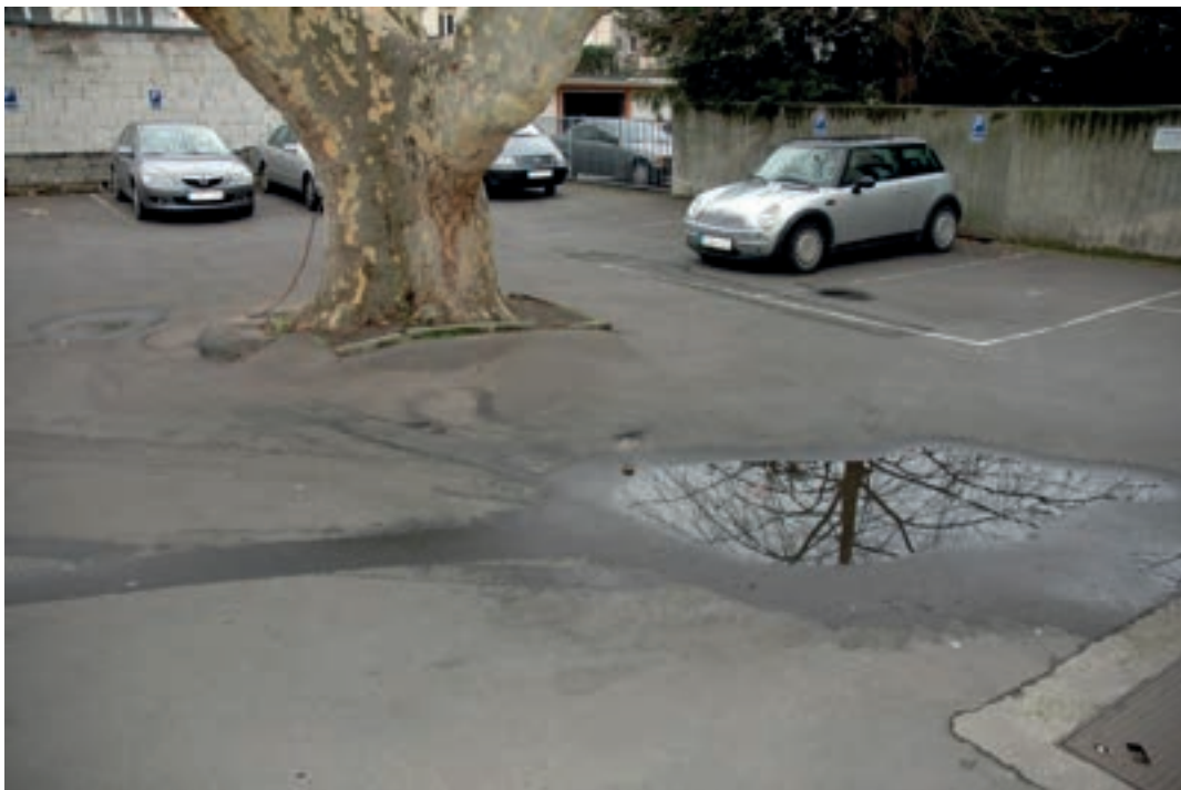
Abbildung 11 vollversiegelte Flächenausbildung, bereits mit Bodenaufwölbungen
